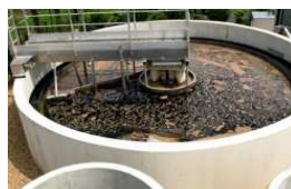
Boues station d'épuration
